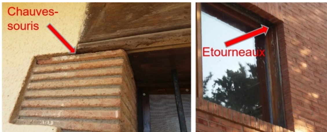
Figure 4 : Les imperfections du bâti : les fenêtres mal posées et les piliers mal scellés constituent des ponts thermiques mais offrent un abri pour la faune sauvage
