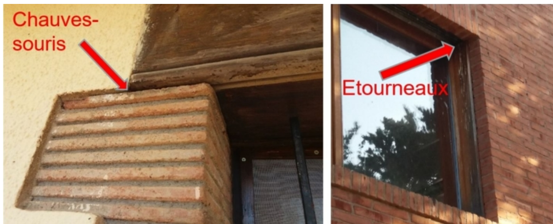
Figure 4 : Les imperfections du bâti : les fenêtres mal posées et les piliers mal scellés constituent des ponts thermiques mais offrent un abri pour la faune sauvage
